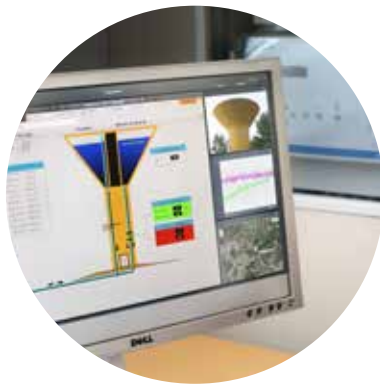
ÖVERGRIPANDE SCADA-SYSTEM: AQUAVIEW 7 s 4
