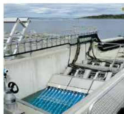
Desinfección UV de agua captación
