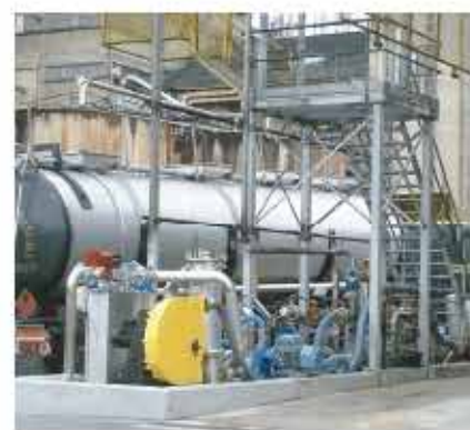
Carga de cisternas de carretera
