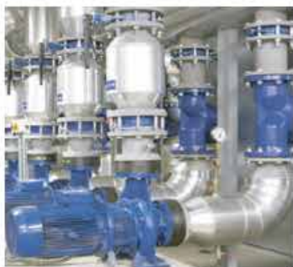
Suministro de agua
