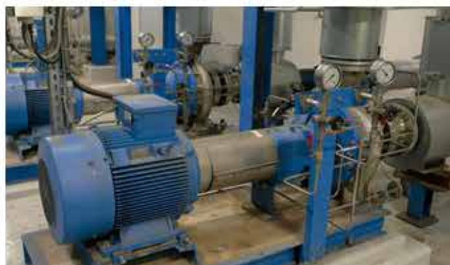
Bombeo de condensados
