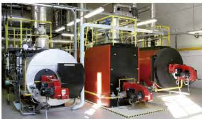
Alimentación de calderas
