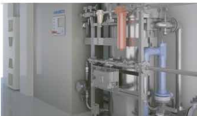
Tratamiento de agua de abastecimiento con ozono
