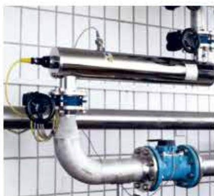
Desinfección de agua de proceso
