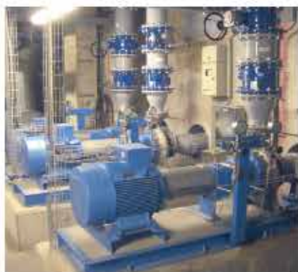
Bombeo de captación
