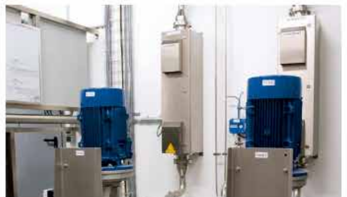
Dstrucción de ozono residual en agua de proceso
