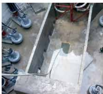
Estación de bombeo para captación de agua de mar
